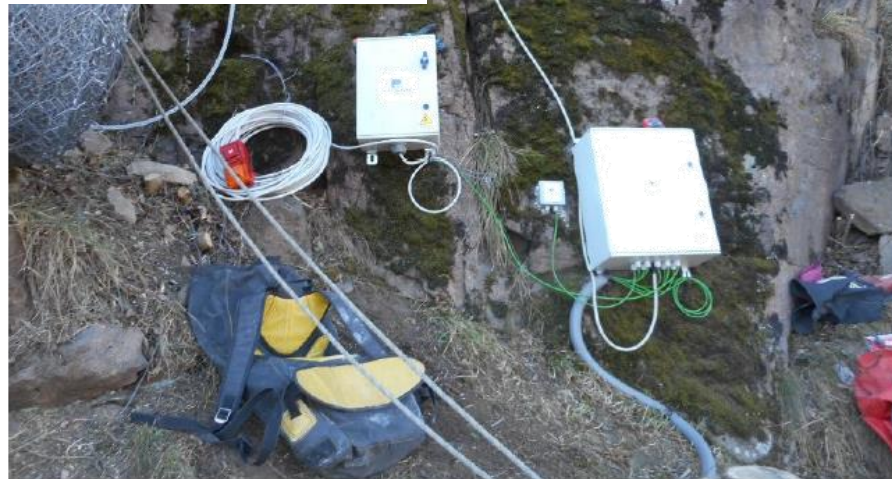
Fig. 5. Acquisitore geotecnico e stazione d'allertamento locale installati sulla sommità della parete rocciosa oggetto del presente monitoraggio.
