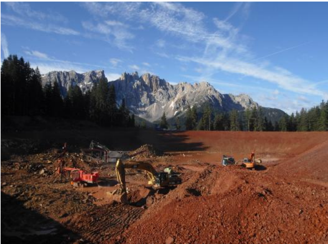
SCAVO IN ROCCIA a CAREZZA (BZ) Rimozione roccia con esplosivi nell'ambito del cantiere per la realizzazione nuovo bacino artificiale da 100.000 mc di invaso
